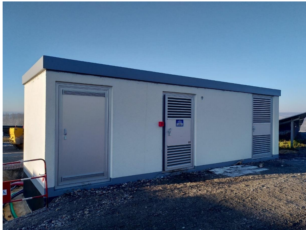
Figure 10 Photographie d'un poste de livraison/transformation
