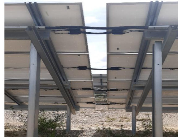
Figure 7 - Câblage sous modules
